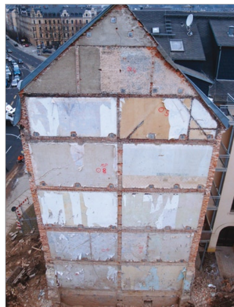
mit Doppelanker gesicherte Giebelwand
